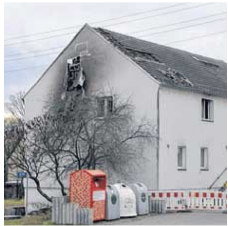
Stark beschädigt: In dem Mehrfamilienhaus Am Ring wütete am Sonnabend ein Brand.
